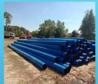
ท่อส่งน้ำแปลงเกษตรใช้ท่อ HDPE ขนาด 315 มม. และ 250 มม.
