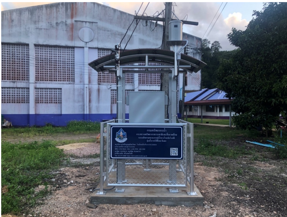
รูปที่ 3.2-5 การติดตั้งเครื่องวัดปริมาณน้ำฝนอัตโนมัติ (Rain Gauge) ที่สถานีสนาม
