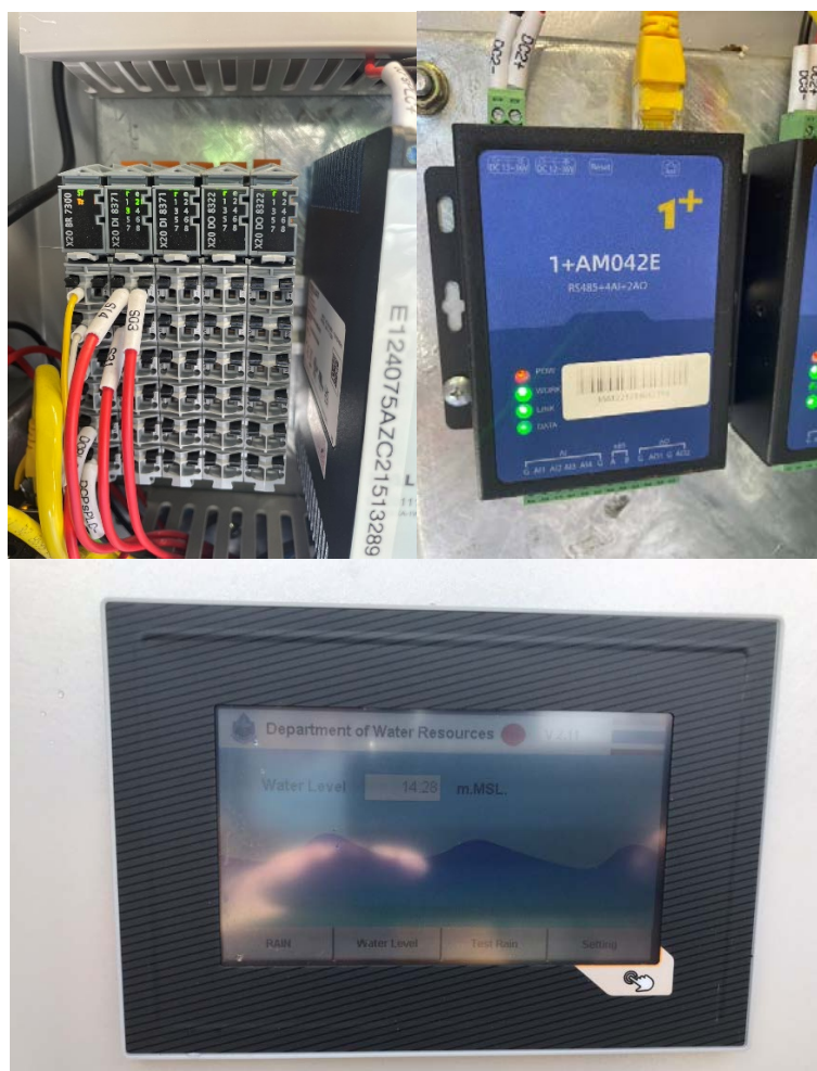
รูปที่ 3.4-2 การติดตั้งอุปกรณ์ควบคุมและประมวลผล (RTU/PLC)
