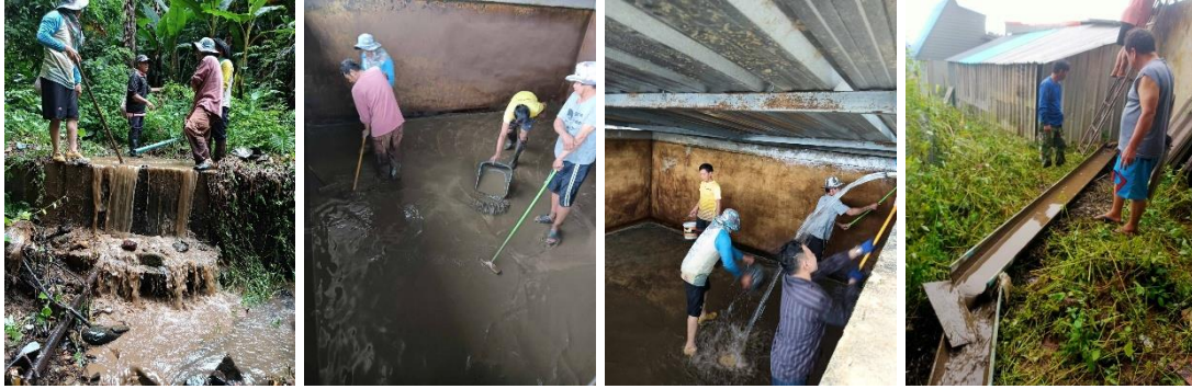
รูปที่ 5.3.1-ข ความเสียหายของระบบประปาภูเขา หมู่ 13 บ้านปางปูเลาะ
