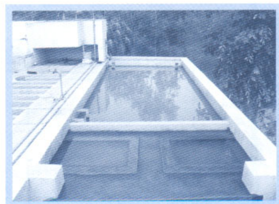
รูปที่ 28 ถังตกตะกอน
