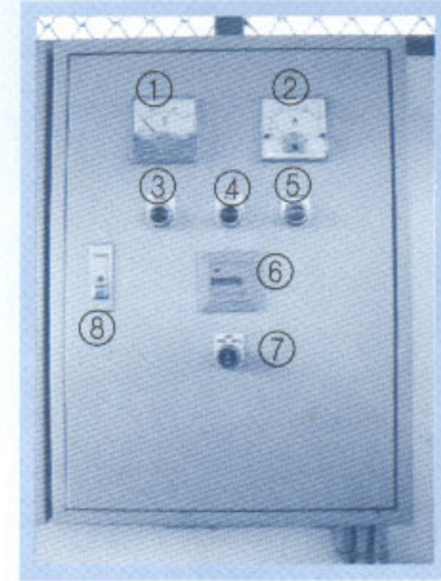
ลักษณะภายนอกตู้ควบคุม
