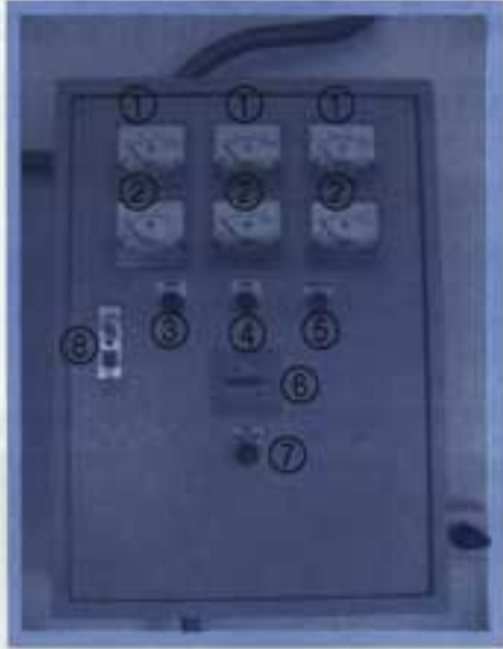
ลักษณะภายนอกตู้ควบคุมเครื่องสูบน้ำดิบ (แบบจมใต้เท้า)
