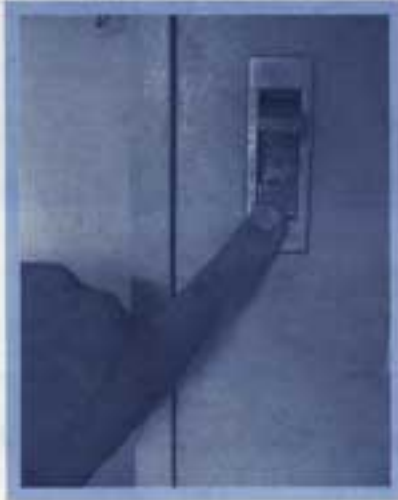
รูปที่ 42 ปุ่มเปิดประตูตู้ควบคุมเครื่องสูบน้ำ
