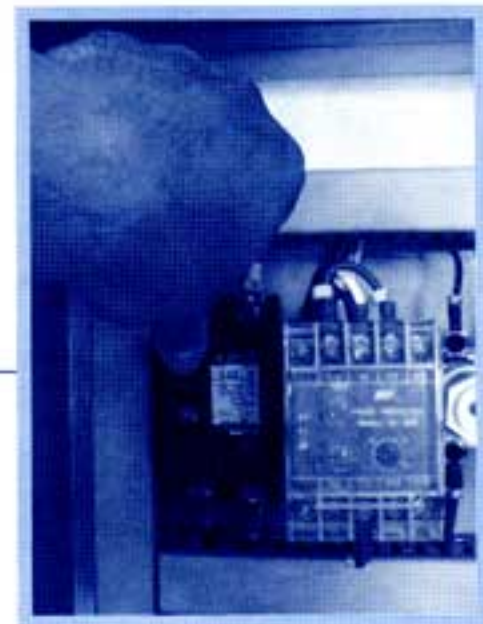
รูปที่ 53 ดัน เบรกเกอร์ ที่ตู้ควบคุมไปที่ตำแหน่ง "ON" ➡
