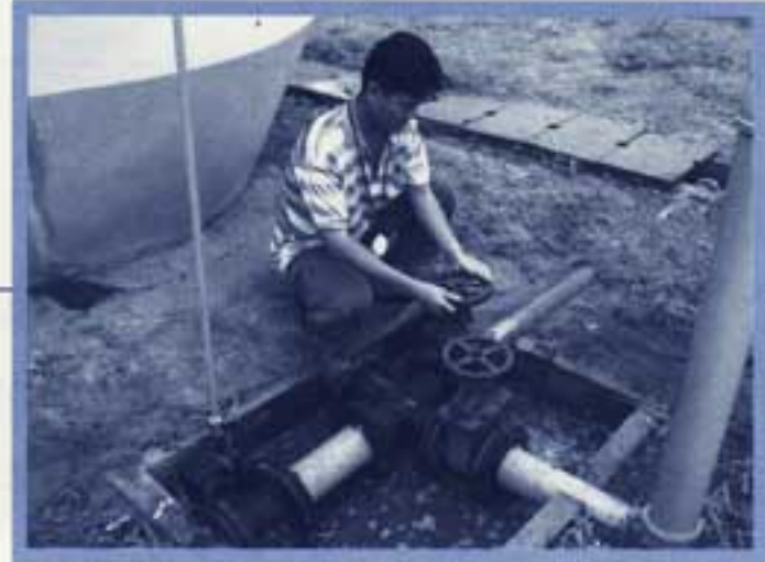
รูปที่ 56 เปิดประตูระบายน้ำทิ้งจากพื้นถังกรอง (ประตูน้ำหมายเลข 4) ➡
