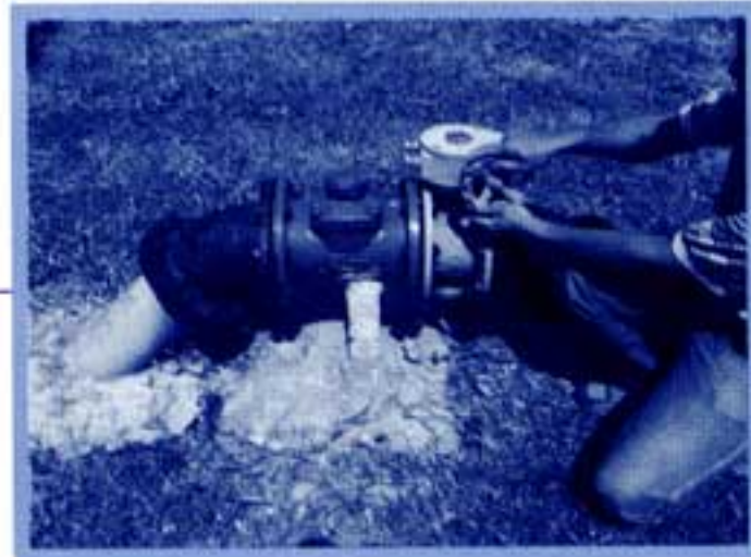
รูปที่ 60 เปิดประตูน้ำจ่ายน้ำประปา (ประตูน้ำหมายเลข 1) ➡
