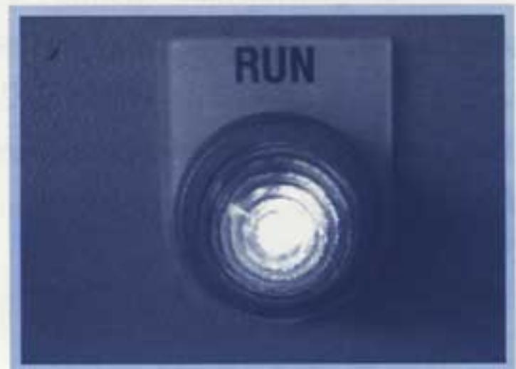
รูปที่ 49 หลอดไฟสีเขียว
