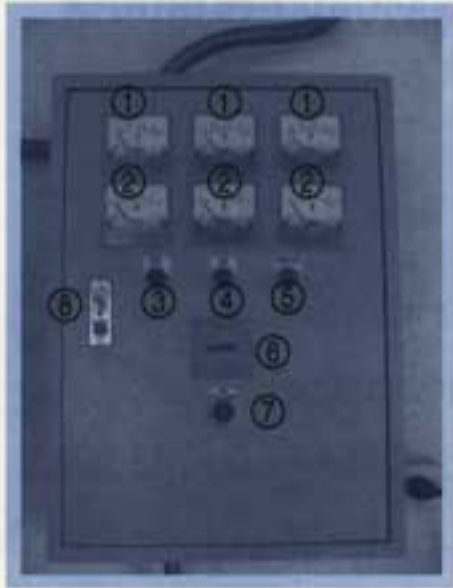
ลักษณะภายนอกตู้ควบคุม เครื่องสูบน้ำดี (แบบหอยโข่ง)
