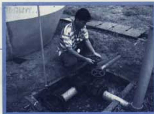
รูปที่ 63 เปิดประตูระบายน้ำทิ้งจาก พื้นถังกรอง (ประตูน้ำหมายเลข 4) ➡
