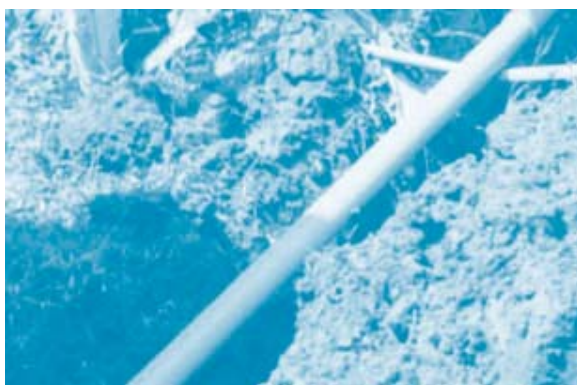
รูปแสดงท่อเมนจ่ายน้ำในระบบประปาหมู่บ้าน
