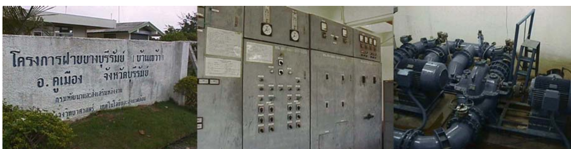
รูปที่ 4.1-10 แสดงห้องควบคุมการทำงานของฝายยาง
