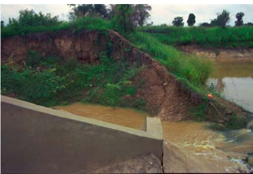
รูปที่ 46 ความเสียหายขั้นที่ 3 เพื่อการซ่อมแซม ปรับปรุง
