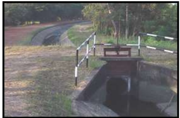
ท่อเชื่อม (Siphon)
