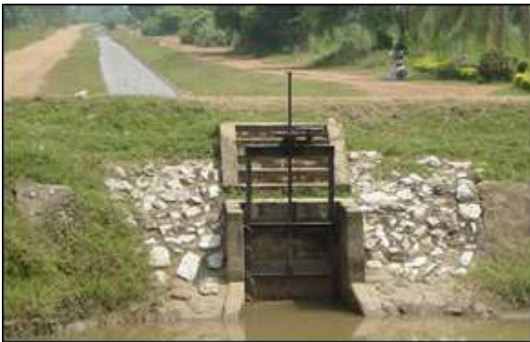
ประตูระบายปากคลองส่งน้ำ
