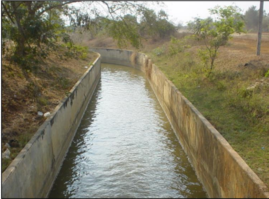
รางน้ำ (Bench Flume)
