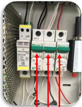
สะพานไฟ
