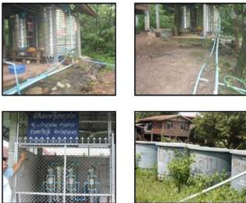
ภาพที่ 124 ระบบประปาภูเขา บ้านภูวงน้อย
